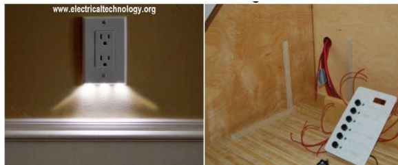
Concealed Conduit wiring
